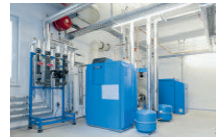
BHKW-Modul Loganova EN20 und Gas-Brennwertkessel Logano plus GB312
