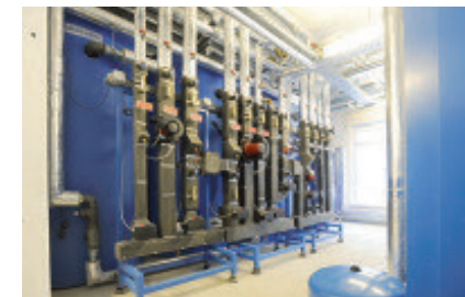
Ein intelligentes Energie- und Speichermanagementsystem stimmt die einzelnen Wärmeerzeuger optimal aufeinander ab.
