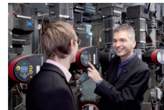
Die hydraulische Installation erfolgte nach dem Baukastenprinzip mit dem Master Energy Control – Hydraulik System Module, einem montagefreundlichen, modular aufgebauten Energie- und Speichermanagement von Buderus. Bild: Felix Krumbholz
