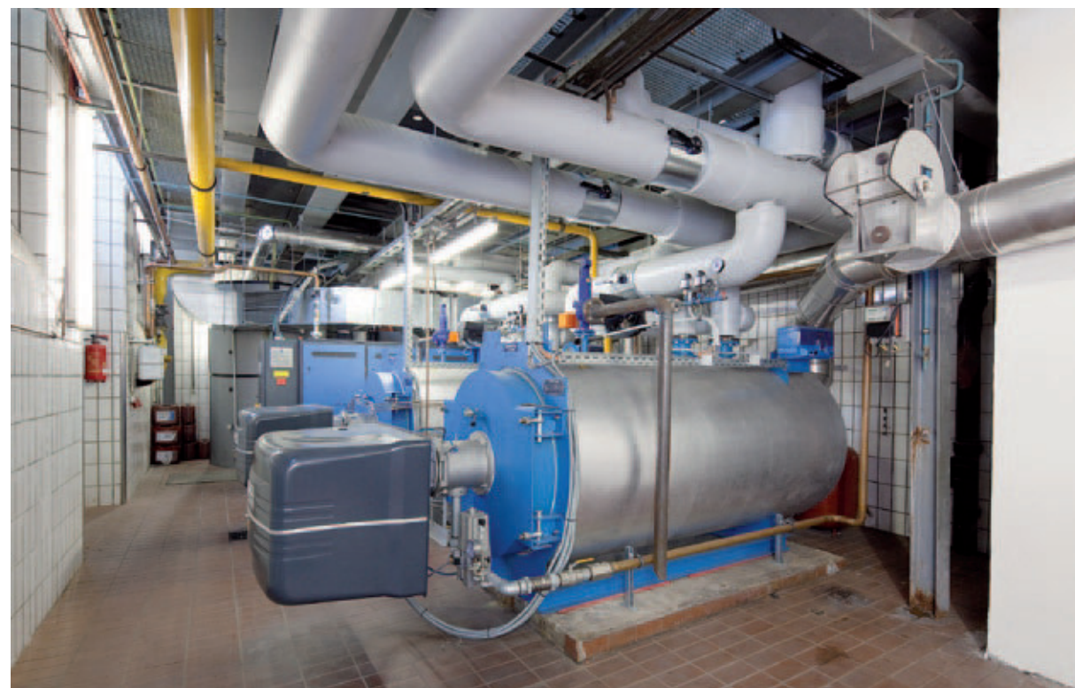
Zwei Buderus Niedertemperaturkessel (links) unterstützen das BHKW (rechts) in Spitzenlastzeiten bei der Warmwasserbereitung. Bild: Felix Krumbholz
