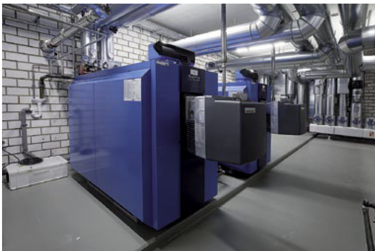
Die Gas-Brennwertkessel Logano plus SB625 in den Leistungsgrößen von je 300 kW nutzen den eingesetzten Brennstoff besonders effizient.
