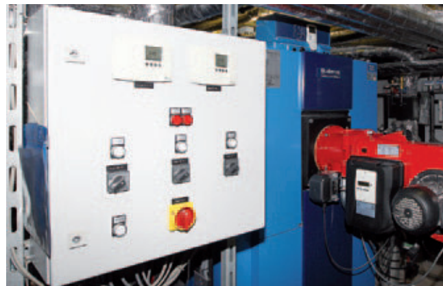
Alle Komponenten sind in ein Regelungssystem eingebunden. Die Stadtwerke Gießen erfassen den Energieverbrauch.
