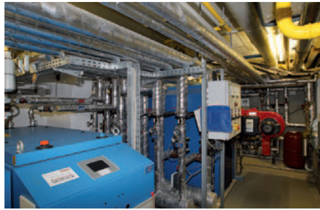
Das hocheffiziente BHKW-Komplettmodul Loganova EN20 (vorne) wird ergänzt durch einen Gas-Brennwertkessel Logano plus SB615 (hinten).
