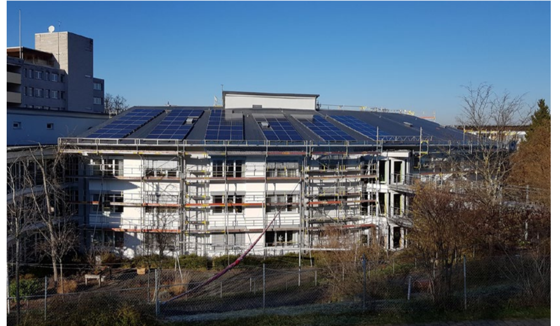
Die Bruderhaus Diakonie hat auf einer Einrichtung eine Photovoltaik-Anlage auf dem Dach installiert.
